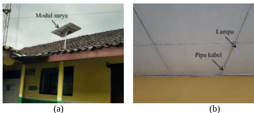
Gambar 5 Instalasi alat di luar ruangan: (a) modul surya, (b) lampu
