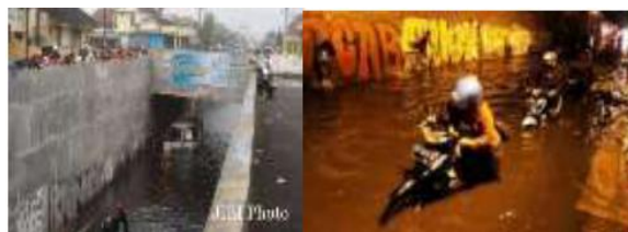
Gambar 3. Banjir yang terjadi di Underpass Makamhaji Sumber: ( www.solopos.com , 2015) diakses 18-10-2020
